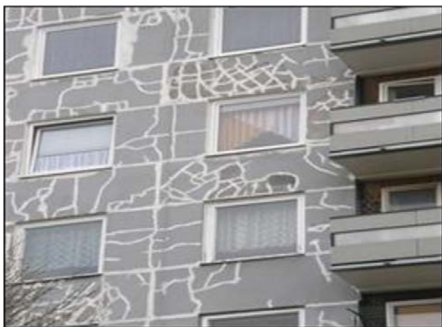
Obrázok 1: Prejavy systémovej poruchy na obvodovom plášti hrúbky 240 mm (napr. T 06B NA)
