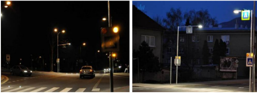
Obr. 21. Priechod pre chodcov so samostatným LED osvetlením, bezpečnostnými LED gombíkmi vo vozovke a doplnkovým výstražným svetlom oranžovej farby
