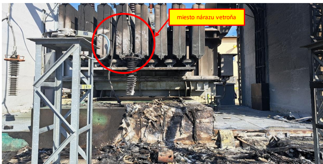
Obr. č. 4 miesto dopadu s pohľadom na transformátor
