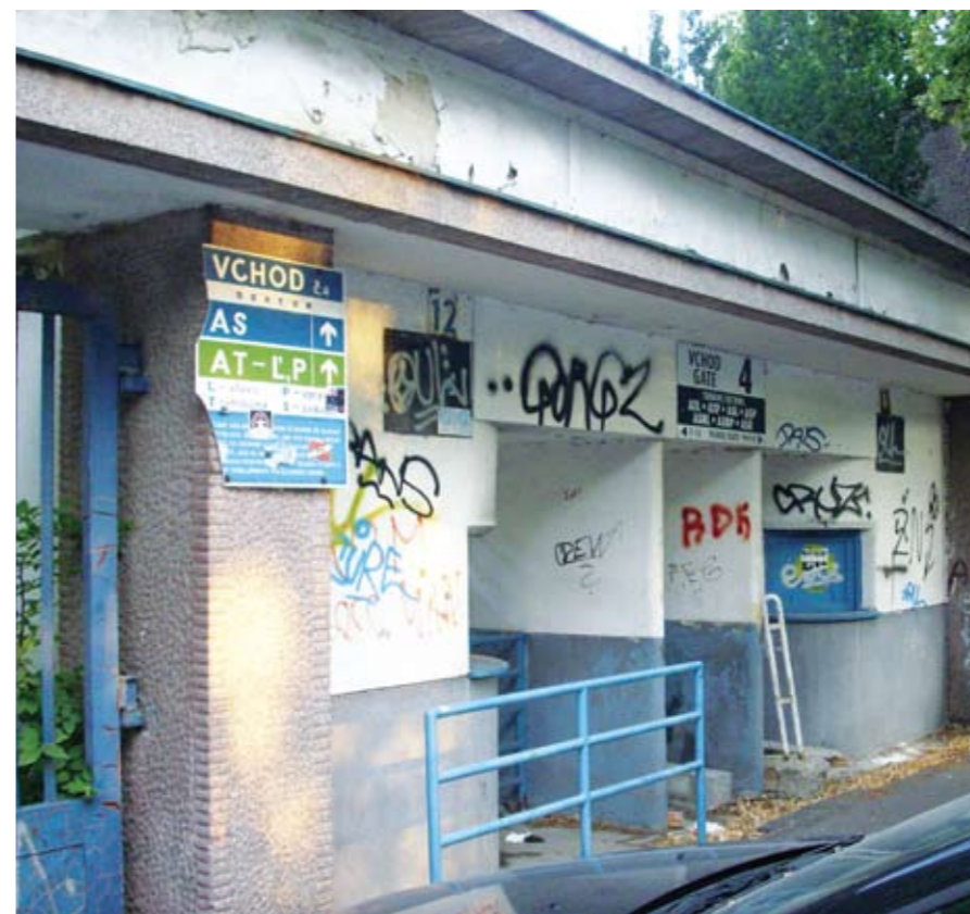
Torzá turniketových portálov futbalového štadióna by sa ešte dali zakomponovať ako atrefakty pôvodného genius loci. Foto: autor, 2013
